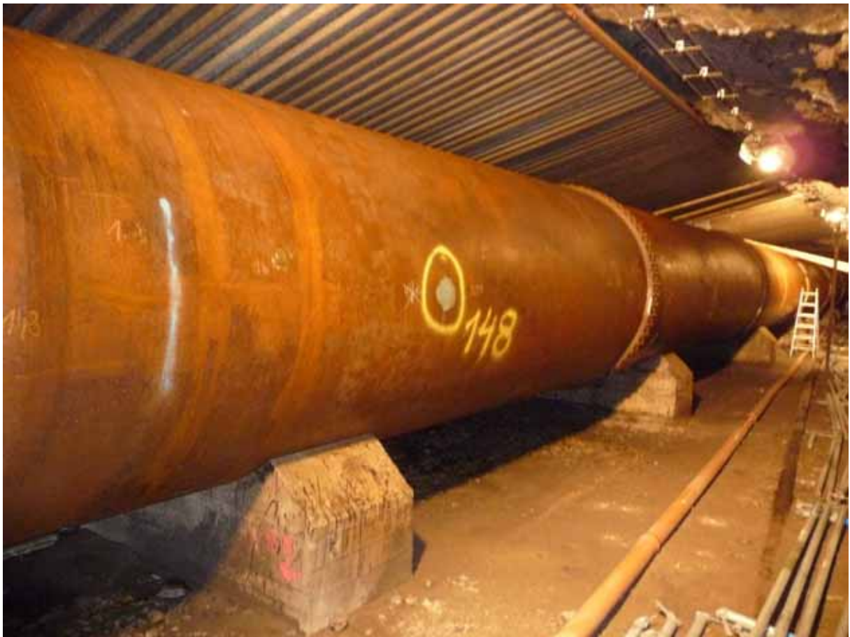
Bild: Außenfläche im inneren Teil der Flachstrecke der Verteilrohrleitung im Stollen nach der Prüfung.
