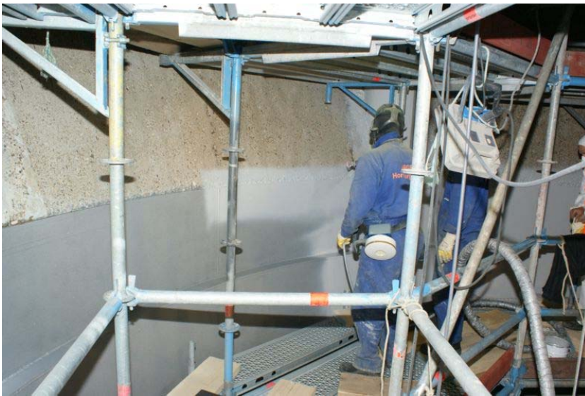
Das Bild zeigt die Applikation der ersten Schicht Humidur in der Senkrechtpanzerung des Einlaufturms
